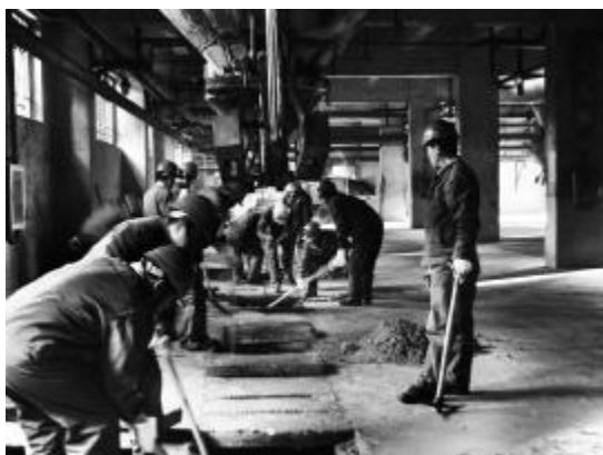
▲近日，煤气分厂造气一车间组织20余名党员及骨干清理发生炉渣沟内的淤泥。经过一整天的清理，共清出废渣淤泥30余立方，为生产创造了良好条件。图为劳动现场。摄影报道 黄国华 丹小忠
