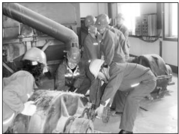
近日，80万吨氧化铝厂六车间利用2#焙烧炉停炉检修的时机，整合现有检修资源，打破常规，集中优势兵力，承担了部分以往外委检修项目，自行完成了2#平盘滤布、4#皮带减速机的更换任务。图为六车间员工正齐心协力更换减速机。摄影报道 张瑞珍
