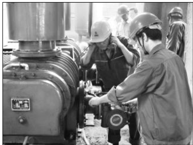
图为安装人员正在调试风机参数。
