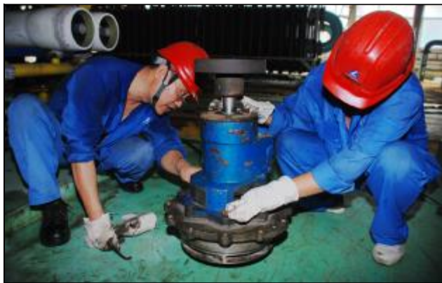
近日,热电厂检修车间党支部在党员中开展“向国庆献礼”活动,车间第三党小组对新系统化学区域除盐泵、中间泵、回水泵等26台泵进行集中达标治理。小组成员利用设备停运及切换时机,对泵的机械密封、盘根、油封、出入口法兰的泄露点进行彻底检修。达标整治后,不仅降低岗位人员劳动强度,还减少了油料消耗及泄漏,提高了设备的运行工况和管理水平。图为小组成员对5号高压泵进行解体检修。摄影报道 夏雷 陈文都
