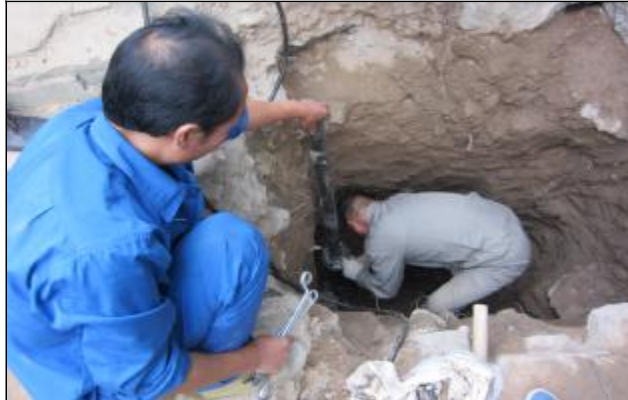
近日,生活服务中心维修二车间加大市场化改革力度,变“守摊吃饭”为“推船下海”,积极开拓外部市场,加大外委转自修力度,最大限度实现增收节支。9月17日,车间主动承担以往外委的居民楼上水管道的更换任务,安装管道30余米,节约费用1.5万元。图为车间维修人员正在维修管道。摄影报道 王海雷
