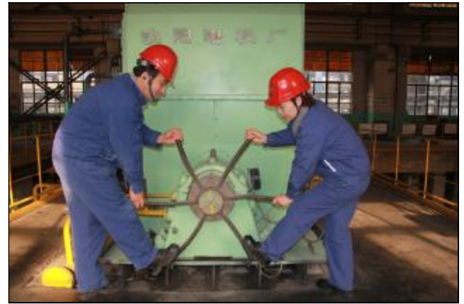
近日，第一氧化铝厂空压站车间员工根据高压机保养维护规定，每天定时对高压机人工盘车，使设备达到良好备用状态。由于高压机内部轴承自重较大，备用状态下容易发生弯曲、摩擦、卡位、锈蚀等现象，高压机岗位员工每天利用制盘车架对备用高压机进行人工盘车，确保轴承曲度和防止锈蚀。摄影报道 张利
