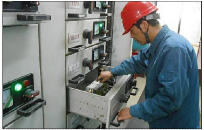
近日,热电分厂电气车间 5 个检修班组对各自管辖的设备、配电室、变压器室进行全面系统排查,在检修记录填写消缺人员,如在节日期间发生故障,车间将按照相应消缺责任人进行处理并考核,做到检修责任落实到人。摄影报道 崔立刚
