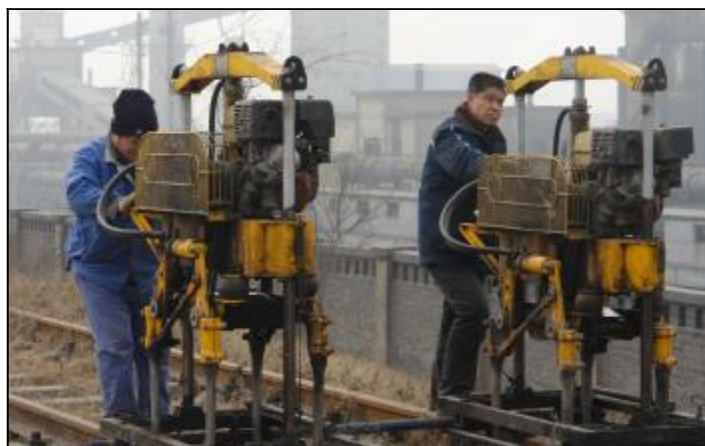
近日,运输部工讯段针对冰雪融化对铁路线路设备质量及安全卡控工作造成的不利影响,开展雪后线路大整治,员工采取徒步检查与机车添乘相结合的方式准确把握线路病害情况,有计划的组织责任班组限期处理,延长设备使用周期。图为员工正在进行捣固作业。摄影报道 丁剑锋 卢建军
