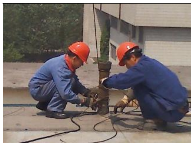
针对夏季大风和雷雨天气增多的现象,水电分厂三车间对所辖的电气设备开展地毯式排查,维护修复避雷设施,确保夏季设备安全稳定运行。图为检修人员正在修复避雷塔。
