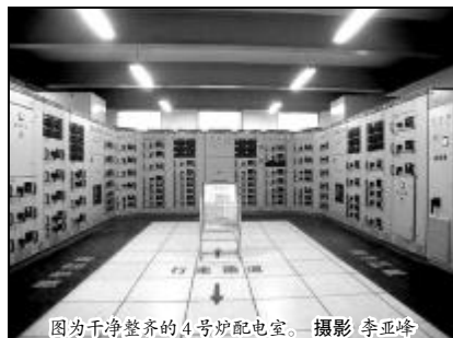
图为干净整洁的4号炉配电室。摄影 李亚峰
