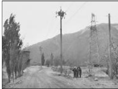
为保障氧化铝生产,水电分厂电气检修车间加大设备巡检力度,及时对担负着生产和生活用水的二期北水供电线路进行隐患消除,为氧化铝生产用水提供有力保障。图为水电分厂电气检修车间员工正在对二期北水线路进行整改。摄影报道 王文杰
