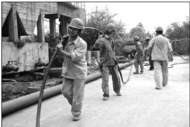
近日,在生活废水站达标排放改造中,水电分厂电气检修车间克服重重困难,挖坑、立杆、架钢角线等,目前已敷设电缆600余米,提前完成SBR池复叶推流曝气机的电源安装,为生活废水站达标排放改造提供有力保障。图为小分队正在拉电缆。
